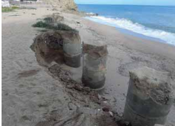
Fonaments soscavats del antics banys i sorra desapareguda per la llevantada a la "Platjola" de Sant Pol.
